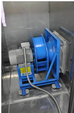
Plug fan inside AHU
